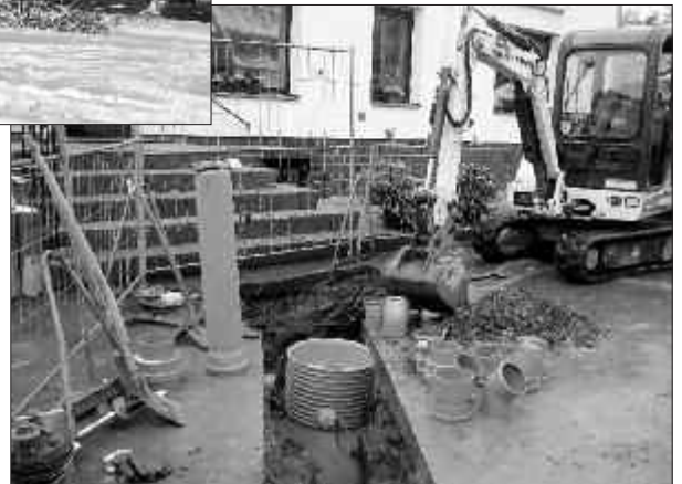
Havarie des Abwasserkanals OT Auerswalde
